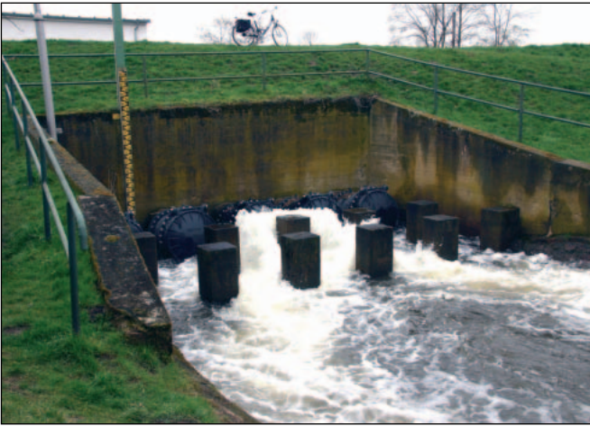
Foto 2: Auslaufbauwerk des Akerer Schöpfwerkes. Insgesamt sind fünf Pumpen installiert, davon eine kleinere zu 0,65 m³/s und vier größere zu je 1,3 m³/s. Im Moment fördert eine von den vier großen Pumpen.
