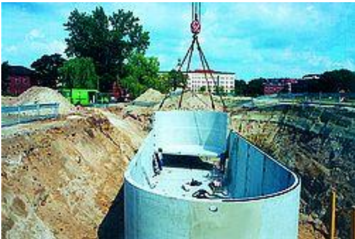
Abbildung 3: Regenwasserrückhaltebecken, Firma Mall (Coswig, Anhalt)
